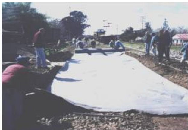
Instalação do geotêxtil Bidim RT21 para separação após a remoção dos trilhos, dormentes e da camada de lastro contaminada pelos finos.
