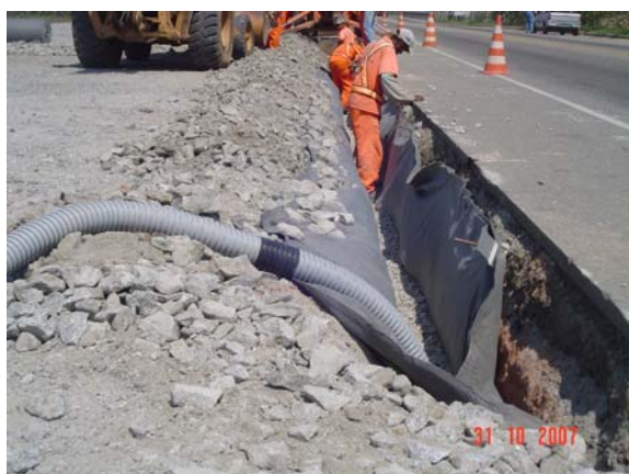
Detalhe da emenda do tubo flexível de drenagem (DN 110mm).
