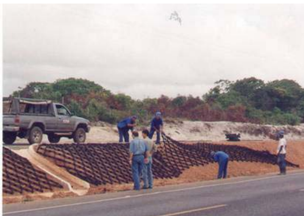
Instalação do Geoweb GW40V3, sendo aberto paralelamente à rodovia para agilizar e aumentar o rendimento da instalação dos painéis.
