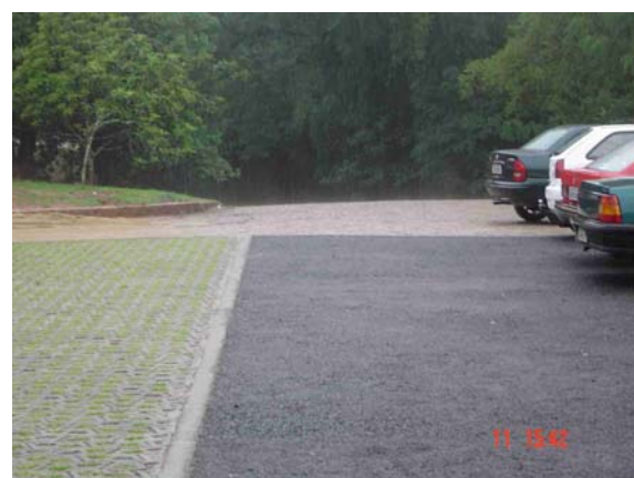
Pavimentos em blocos de concreto vazados e em concreto permeável já executado. Após chuva intensa não se nota acúmulo de água.
