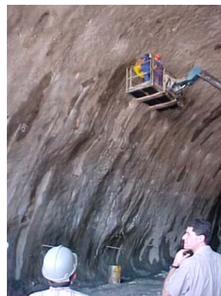
Situação das surgências d'água nas paredes dos túneis.
