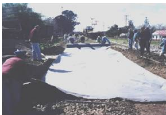
Instalação da Manta Geotêxtil Bidim RT-21 para separação após a remoção dos trilhos, dormentes e da camada de lastro contaminada pelos finos.
