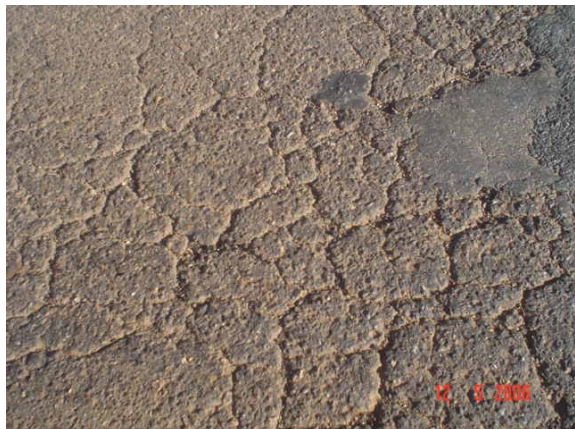
Padrão de trincamento do pavimento
